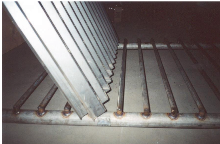
Supporto dei turbo steel plates
